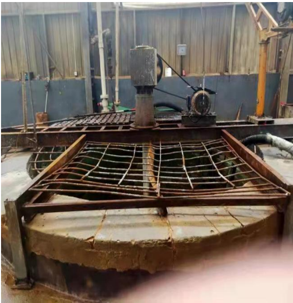
硫酸亚铁溶解槽池
