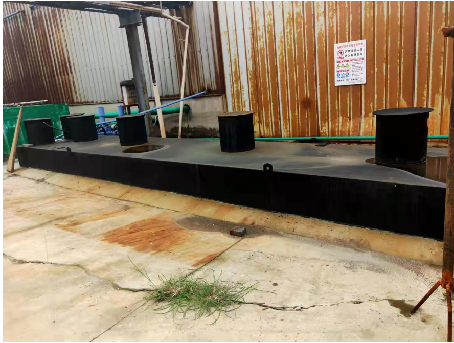
一体化污水处理设施
