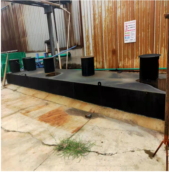
一体化污水处理设施
